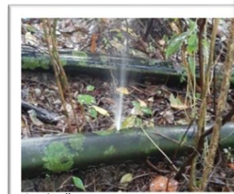
12: Fuite d'eau source (CA 972)
